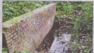
Der Durchfluss unter der Brücke zwischen den Schachtteichen ist verstopft.
