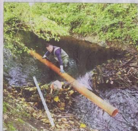
Ein Mitarbeiter des Biosphärenreservates Mittelbe legt durch den errichteten Biberstaumdammen ein langes Kanalgründrohr. Es soll den angestautes Wasserstand auf niedrigem Niveau halten.
